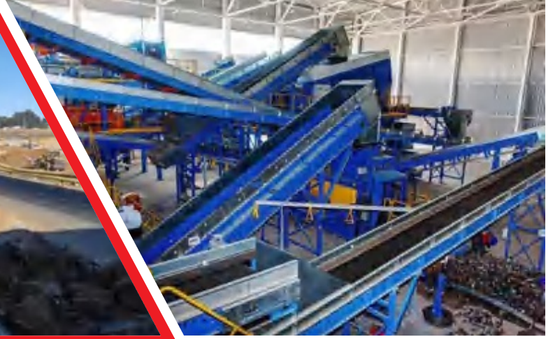
GERİ DÖNÜŞÜM TESİSİ RECYCLING FACILITY
